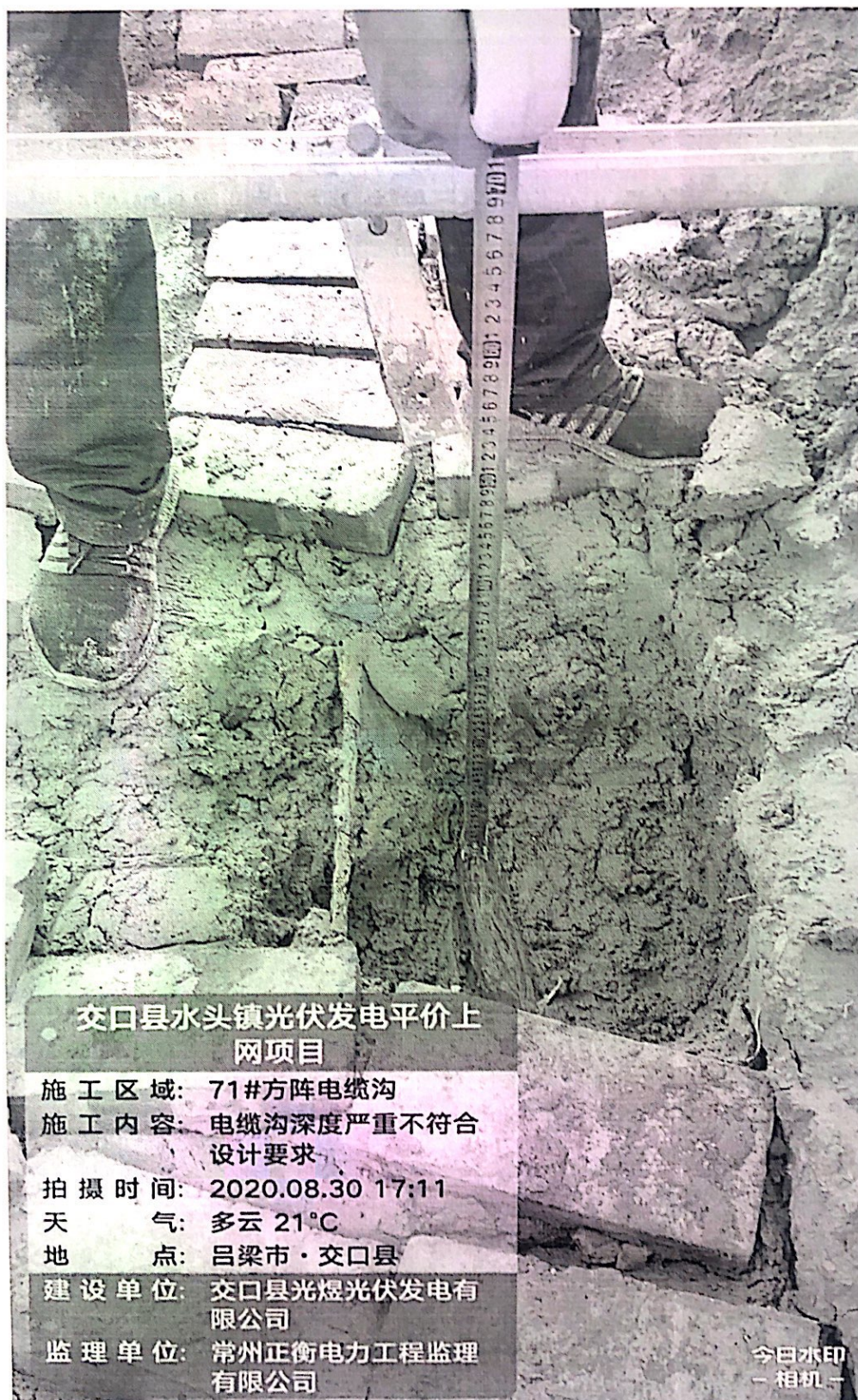
电缆沟深度不达标
