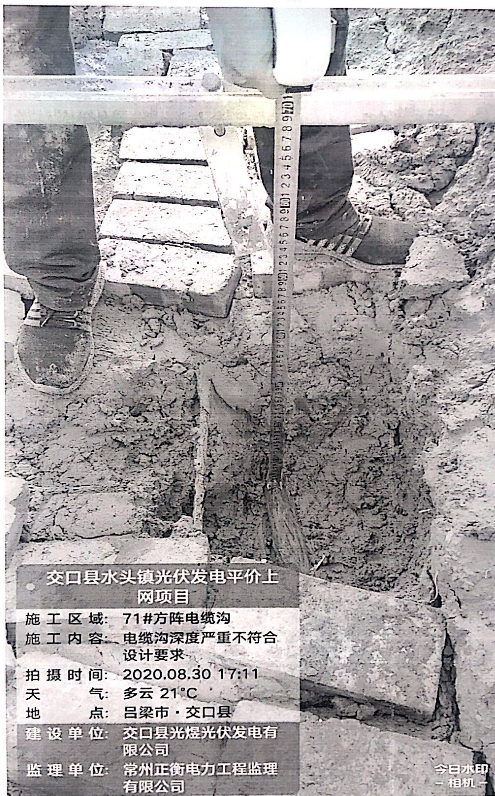
电缆沟深度不达标
