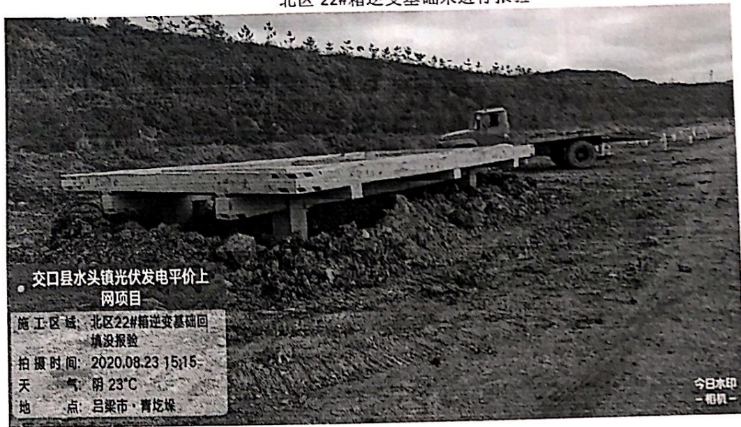
北区 22#箱逆变基础未进行报验
