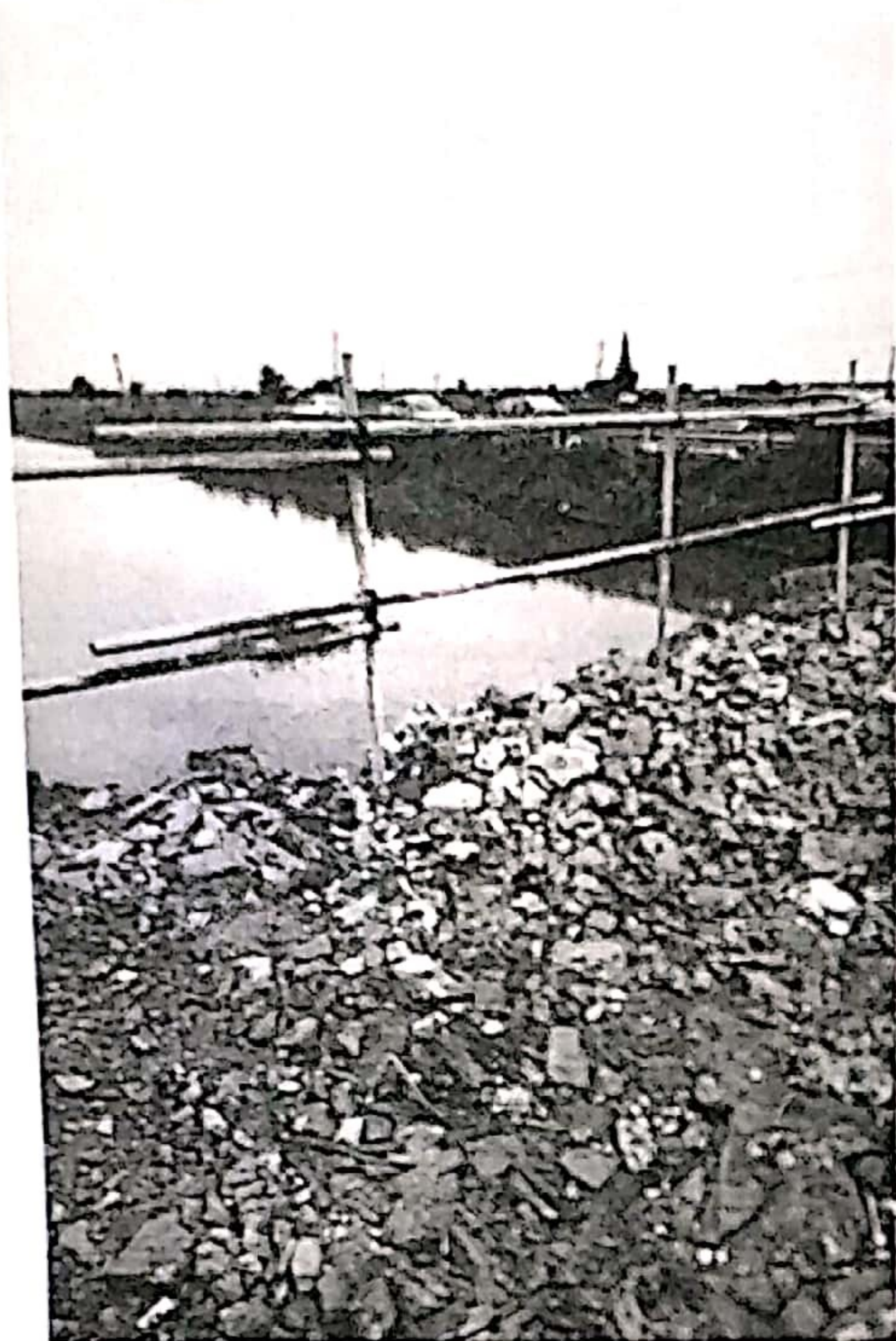
主进场道路安全护栏
