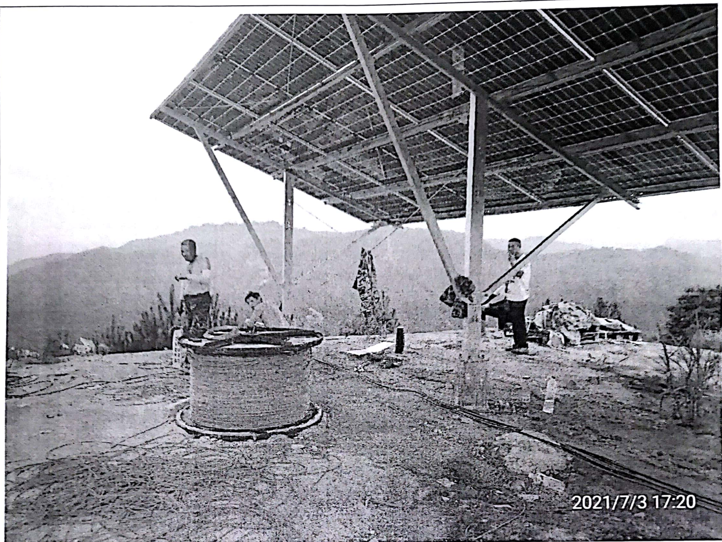
驮龙光伏区少数施工人员未佩戴安全帽
