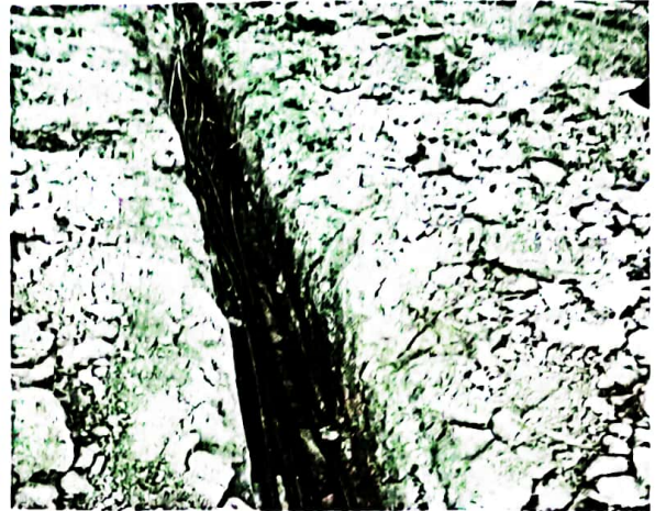
2、电缆沟坍塌部分已清理；
