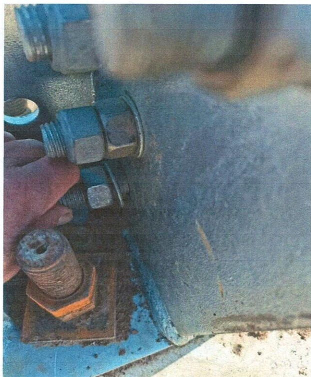
相片一：螺栓未紧固
