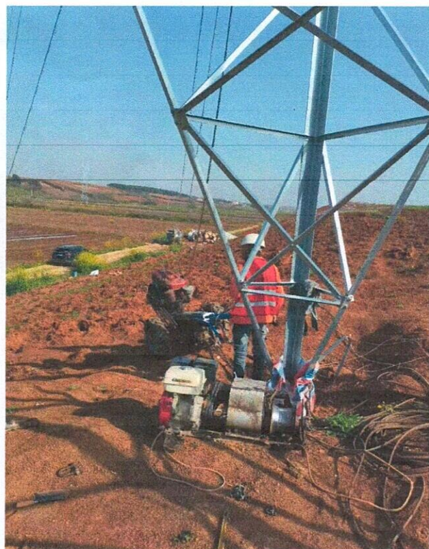
相片三：架线道路未见安全警示标识牌
