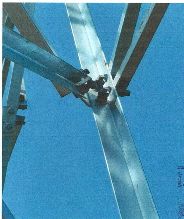
相片二：螺栓未紧固
