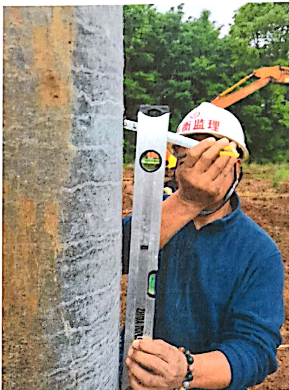
相片二：桩基垂直度偏差
