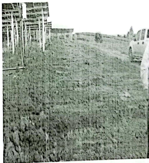
相片四：高压电缆沟未盖砖，未报验，私自回填
