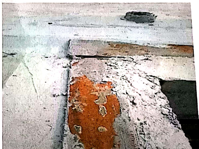
A03 预埋槽钢平整度偏大
