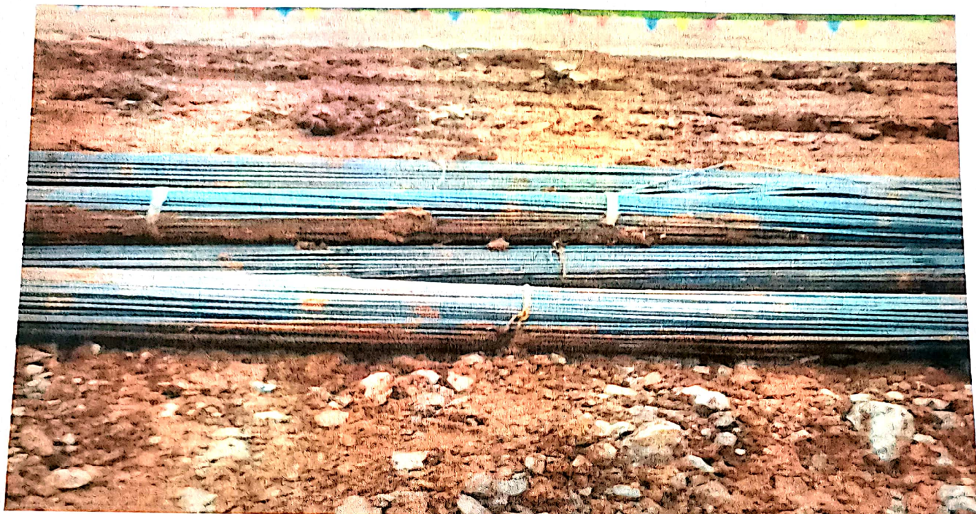
钢筋需加垫台、钢筋沾有大量泥土
