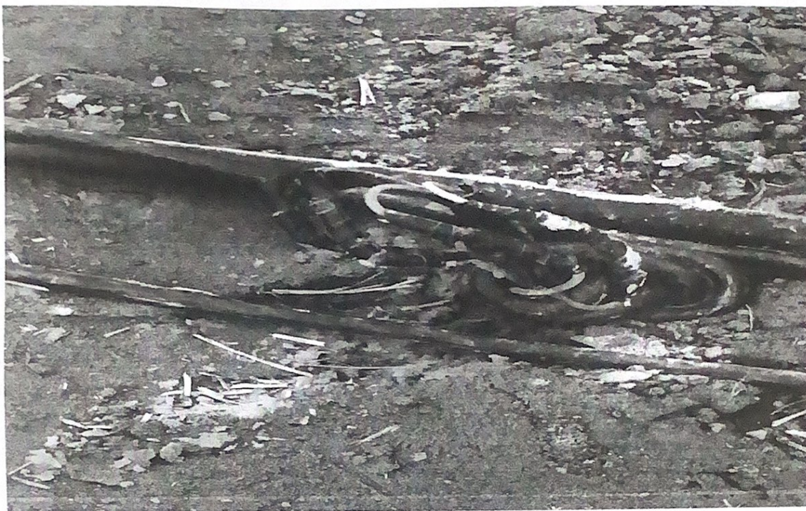
现场电缆接头不规范
