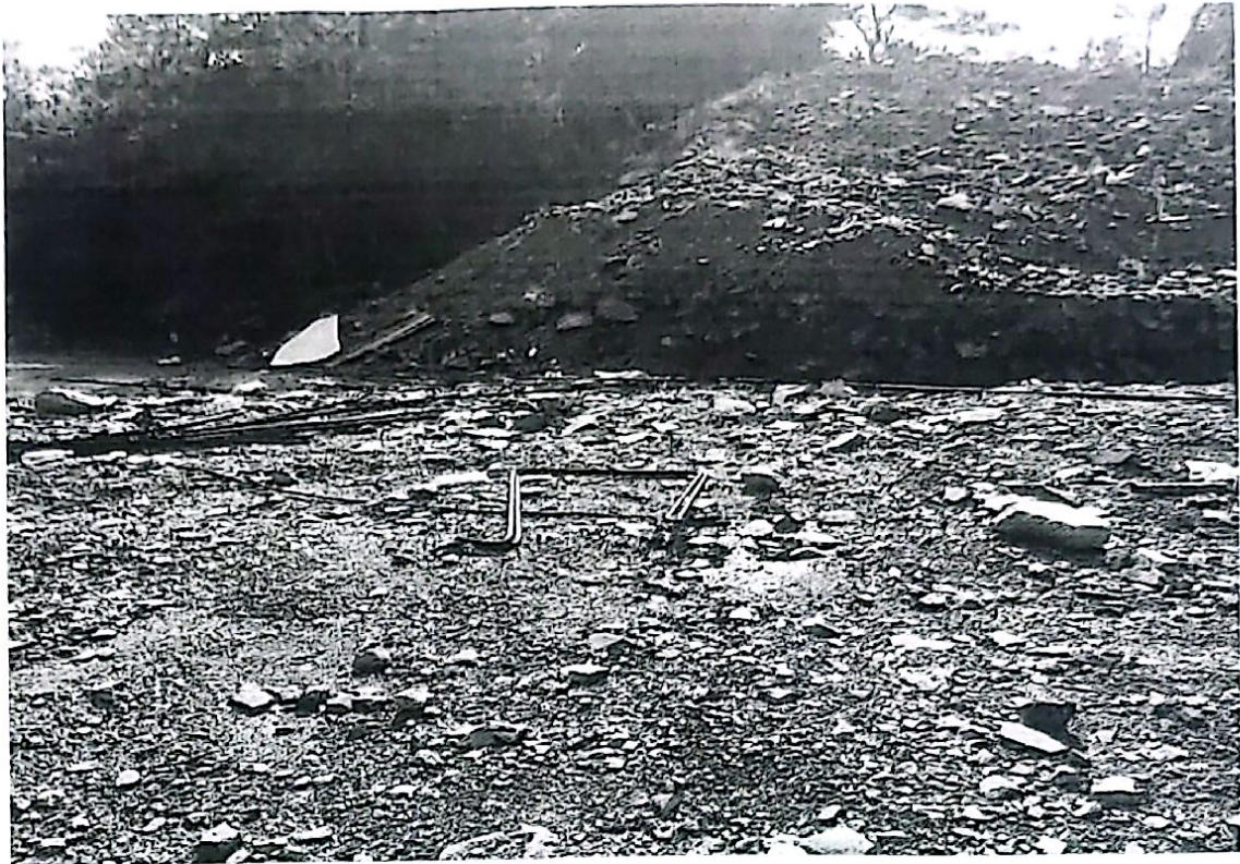
06#风机基础施工现场垃圾未清理
