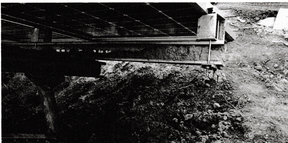
横梁上泥土未清理
