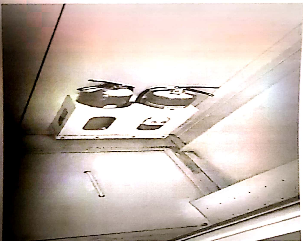
箱变低压侧内及灭火器有积雪
