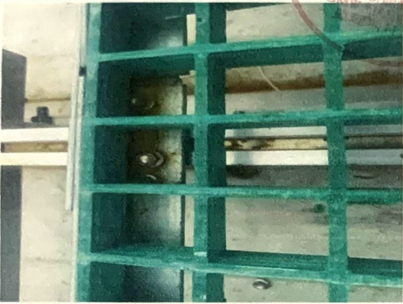
运维通道紧固件生锈
