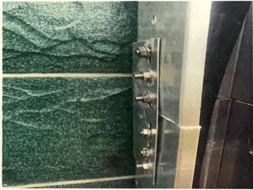
桥架紧固件未紧固
