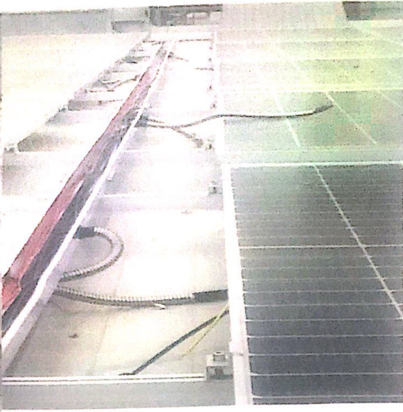
组件安装横平竖直不齐
