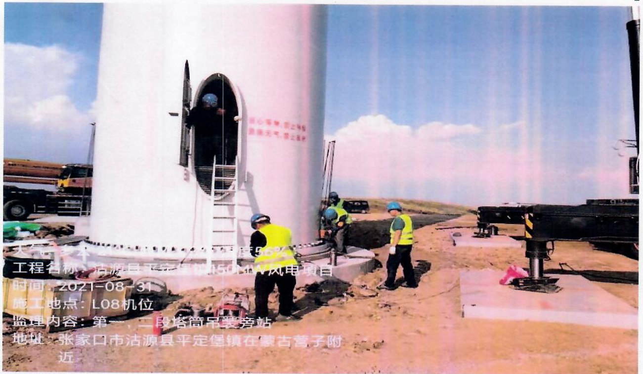
施工人员未正确佩戴安全帽、吊装现场未设置警戒带和警示标识
