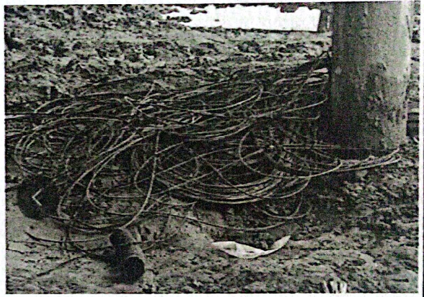
1*4 电缆线随意摆放地面
