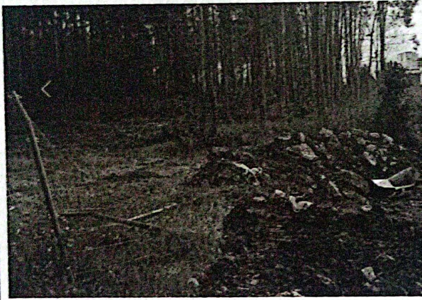
光伏区围栏缺口未修复
