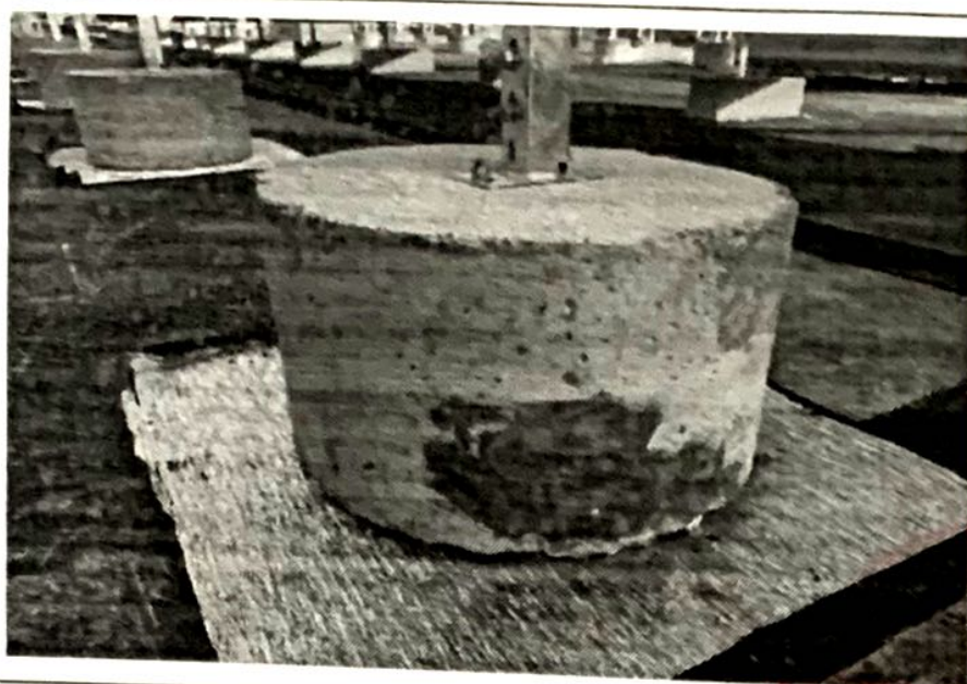
个别水泥基础存在修补情况
