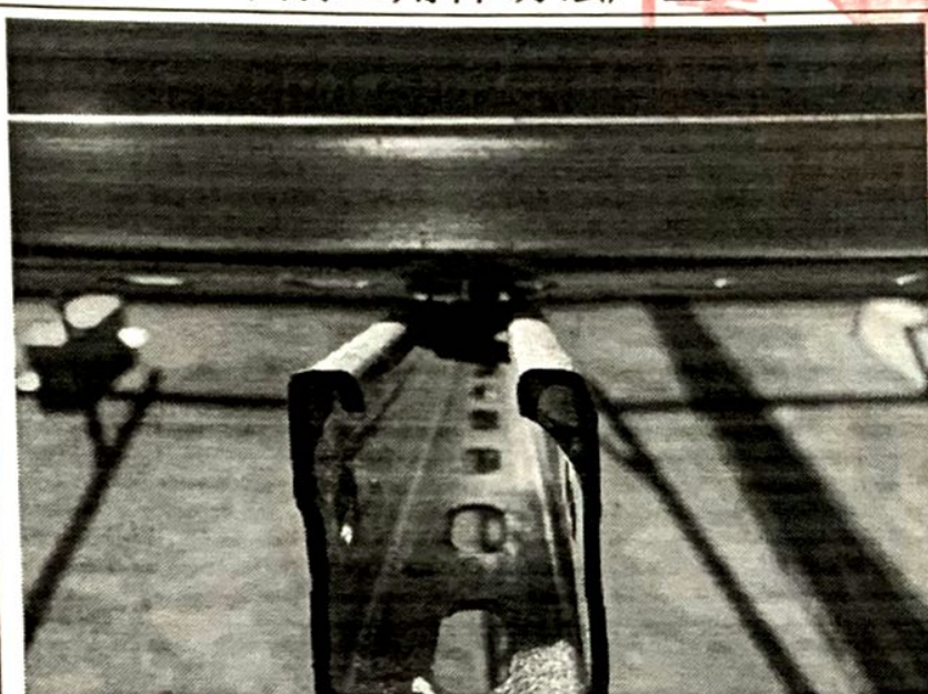
部分支架安装未紧固
