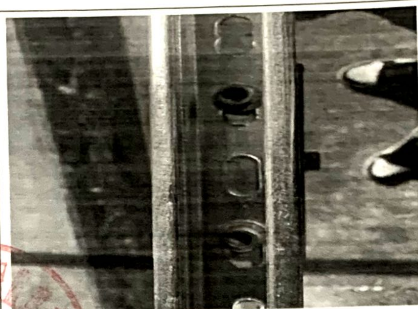
部分支架紧固件锈蚀
