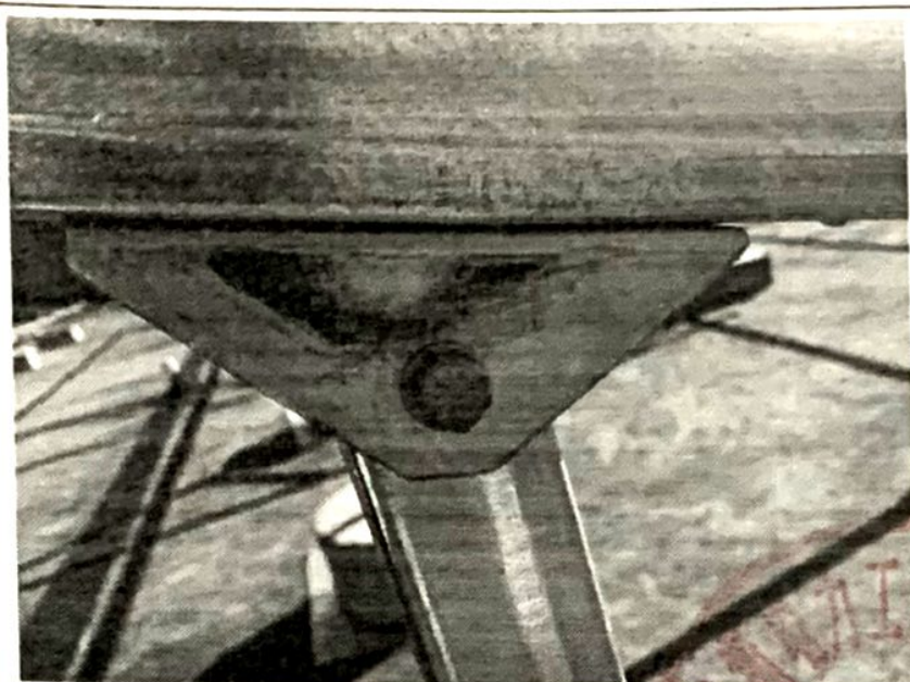
个别三角件锈蚀严重
