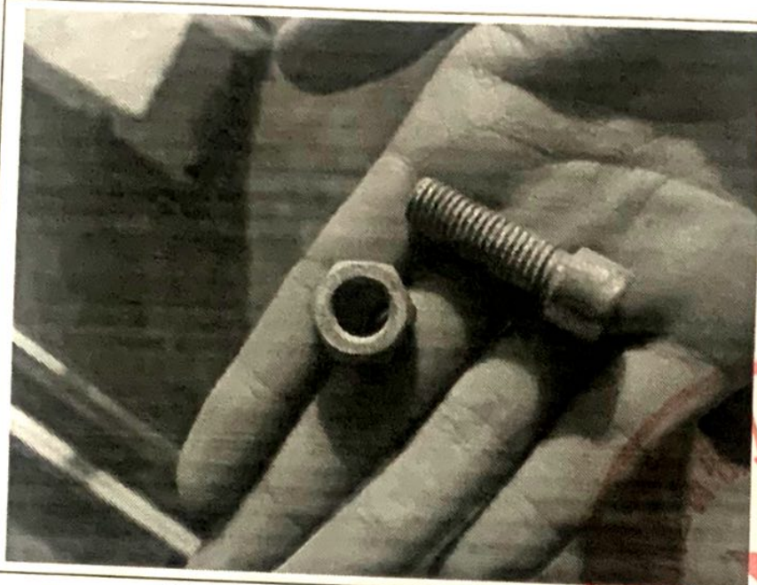
紧固件镀锌层氧化严重
