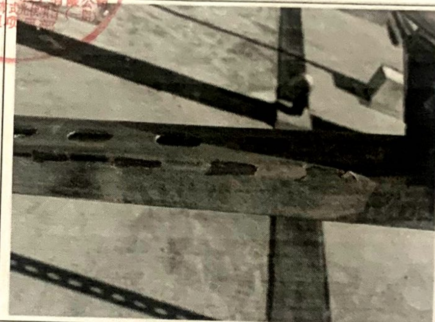
支架镀锌层掉落
