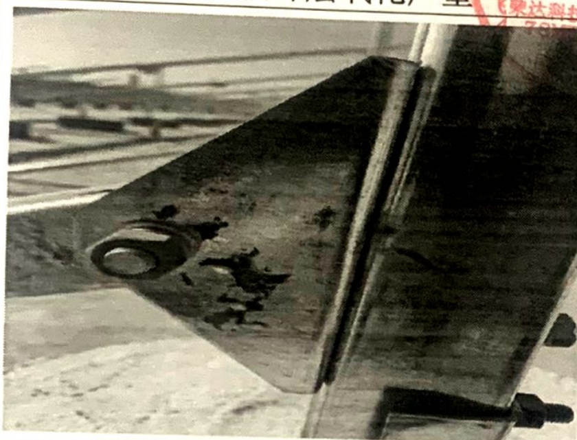
三角件镀锌层掉落
