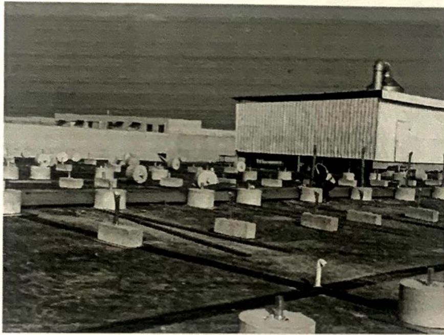
个别施工人员未佩戴安全帽
