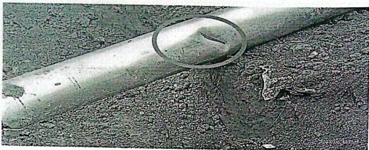
因镀锌钢管壁厚太薄，被钩机碰撞导致凹陷
