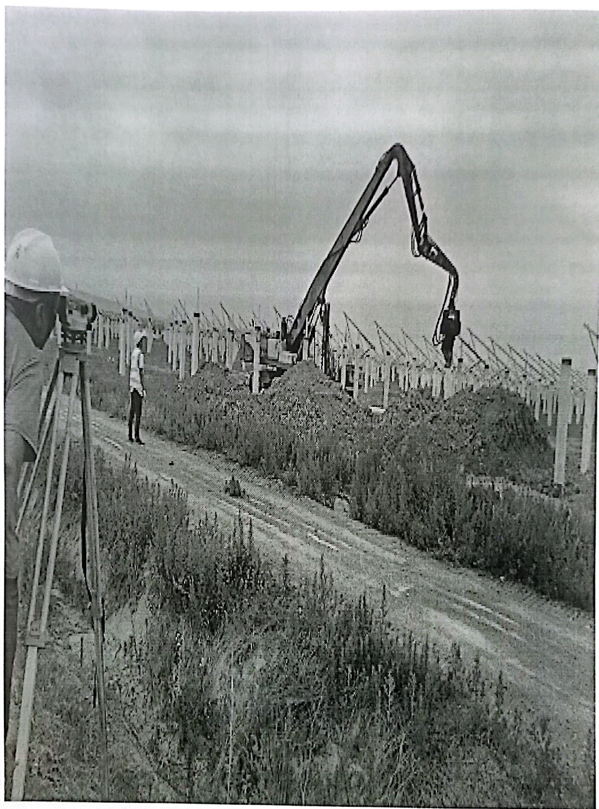
附件：现场整改照片
