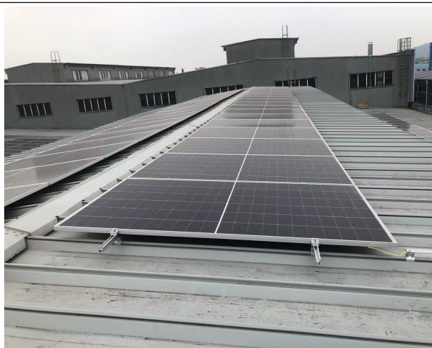
防雷接地安装在运维通道板上
