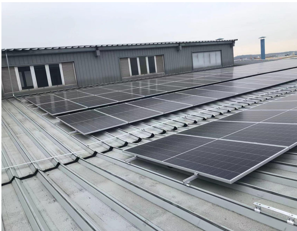
气楼防雷接地安装不规范
