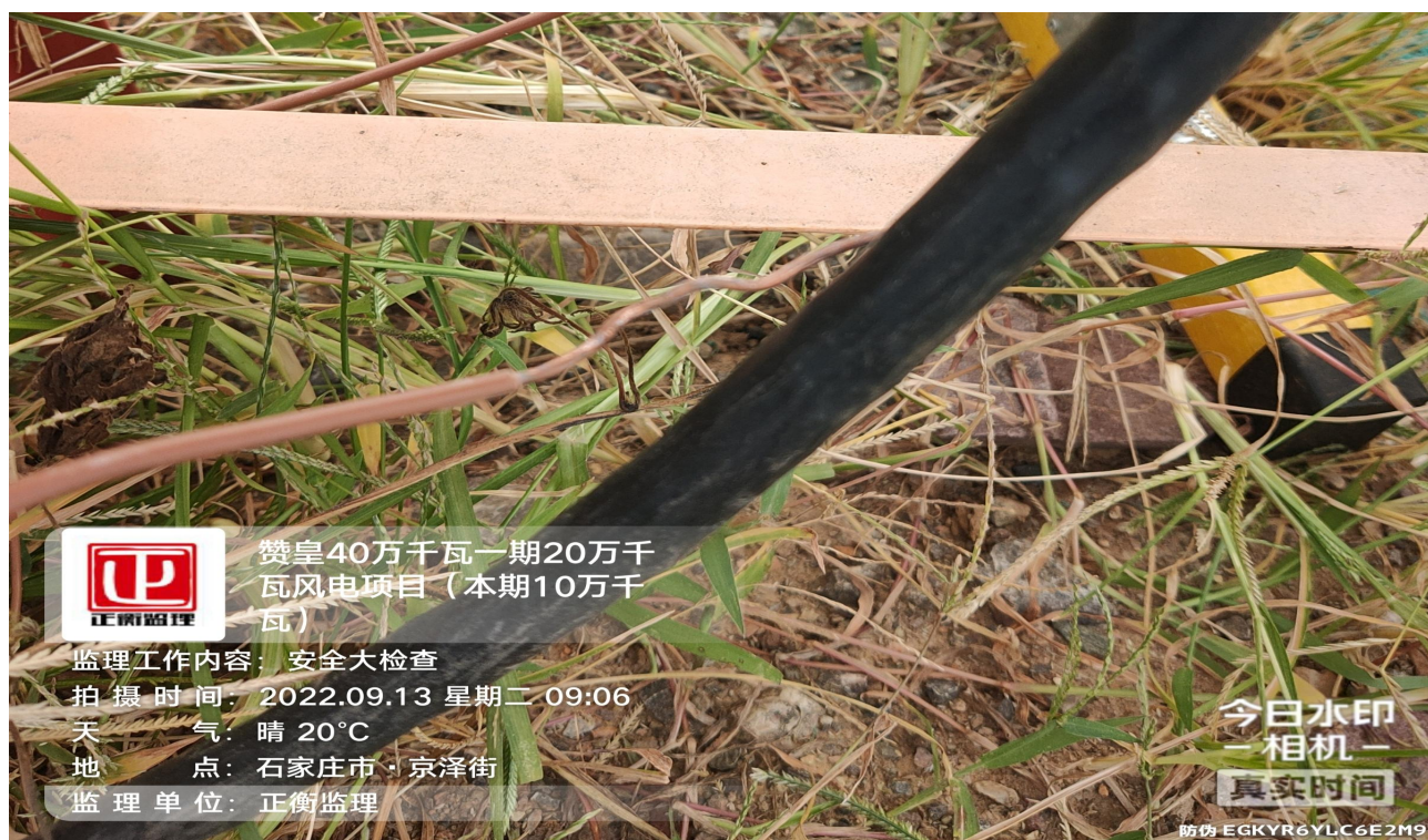
配电箱接地线未接
