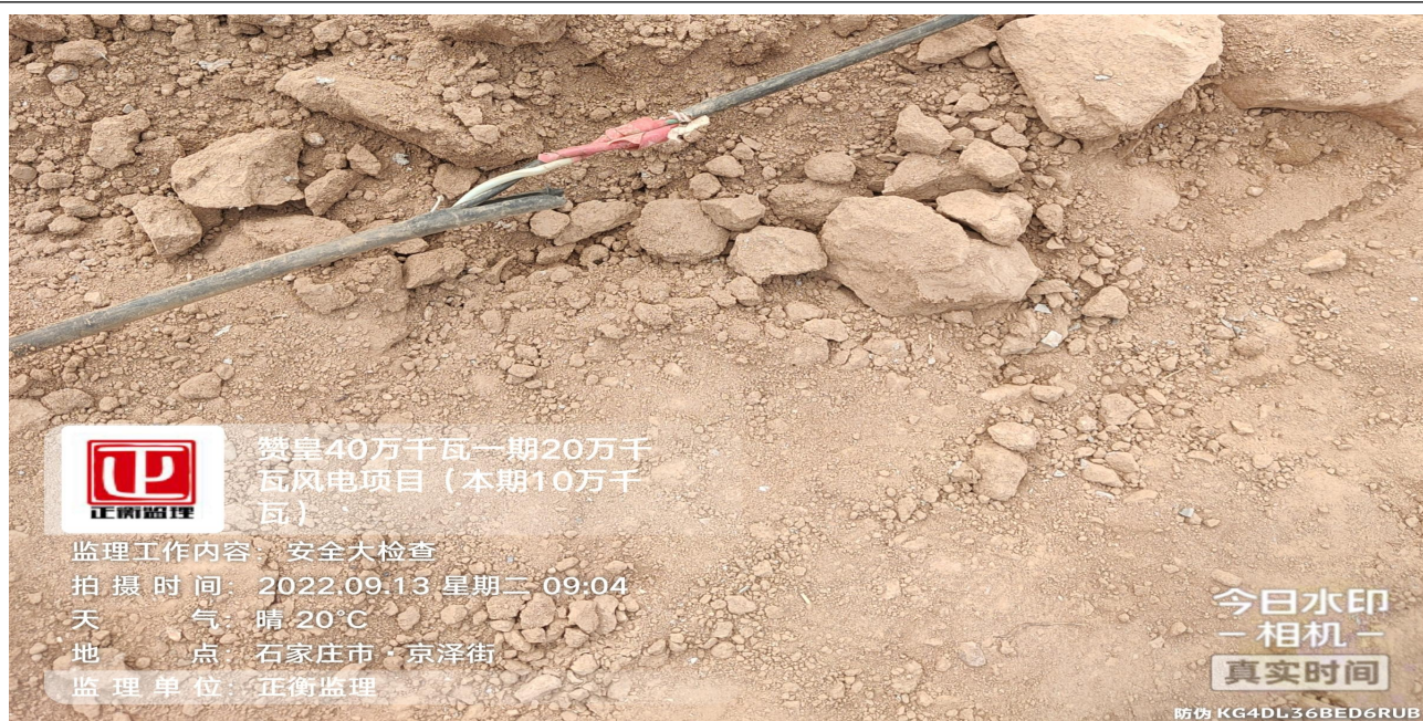
导线接头存在安全隐患、必须更换。
