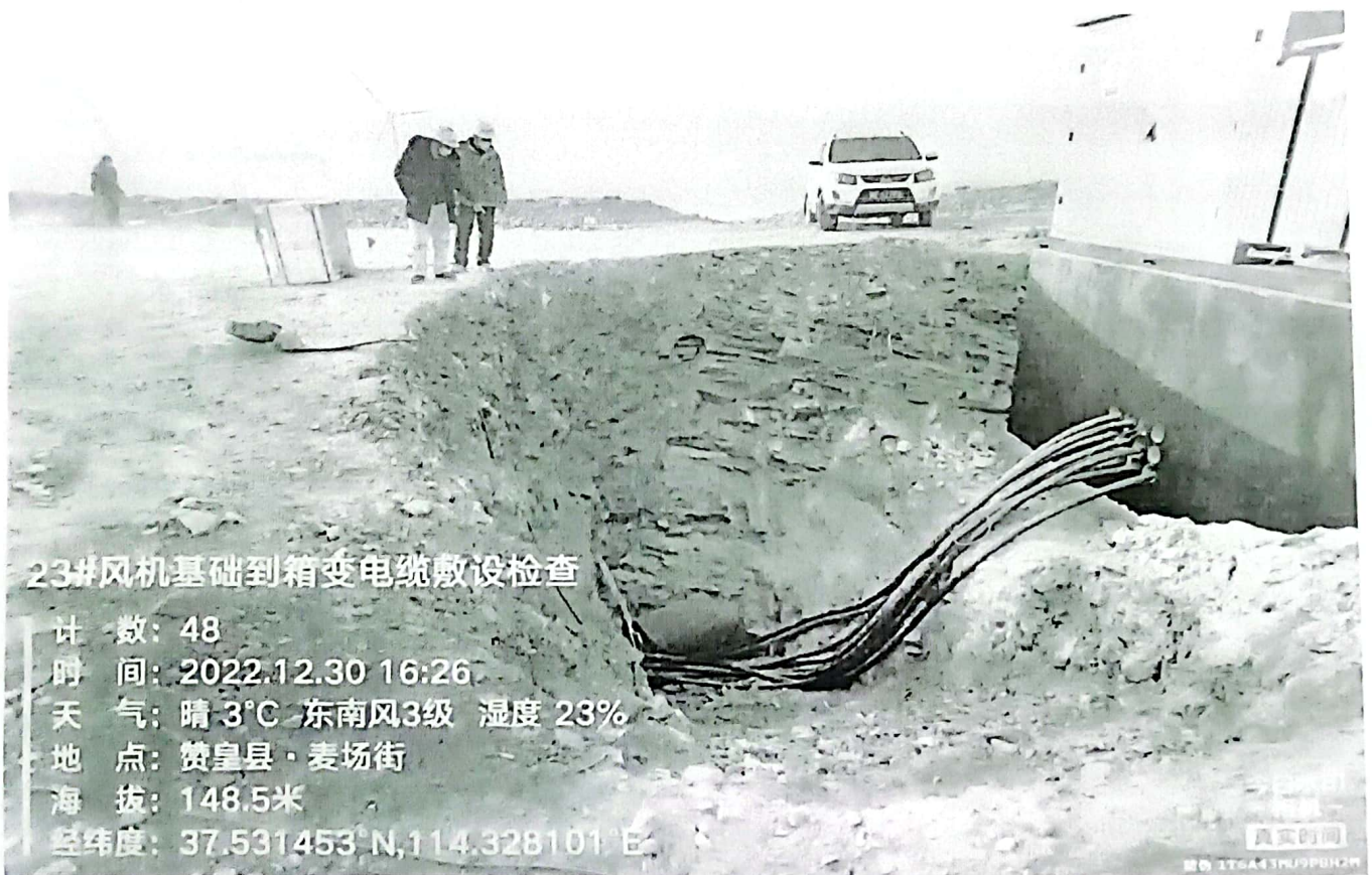
图2 23#处临边防护设置不到位
