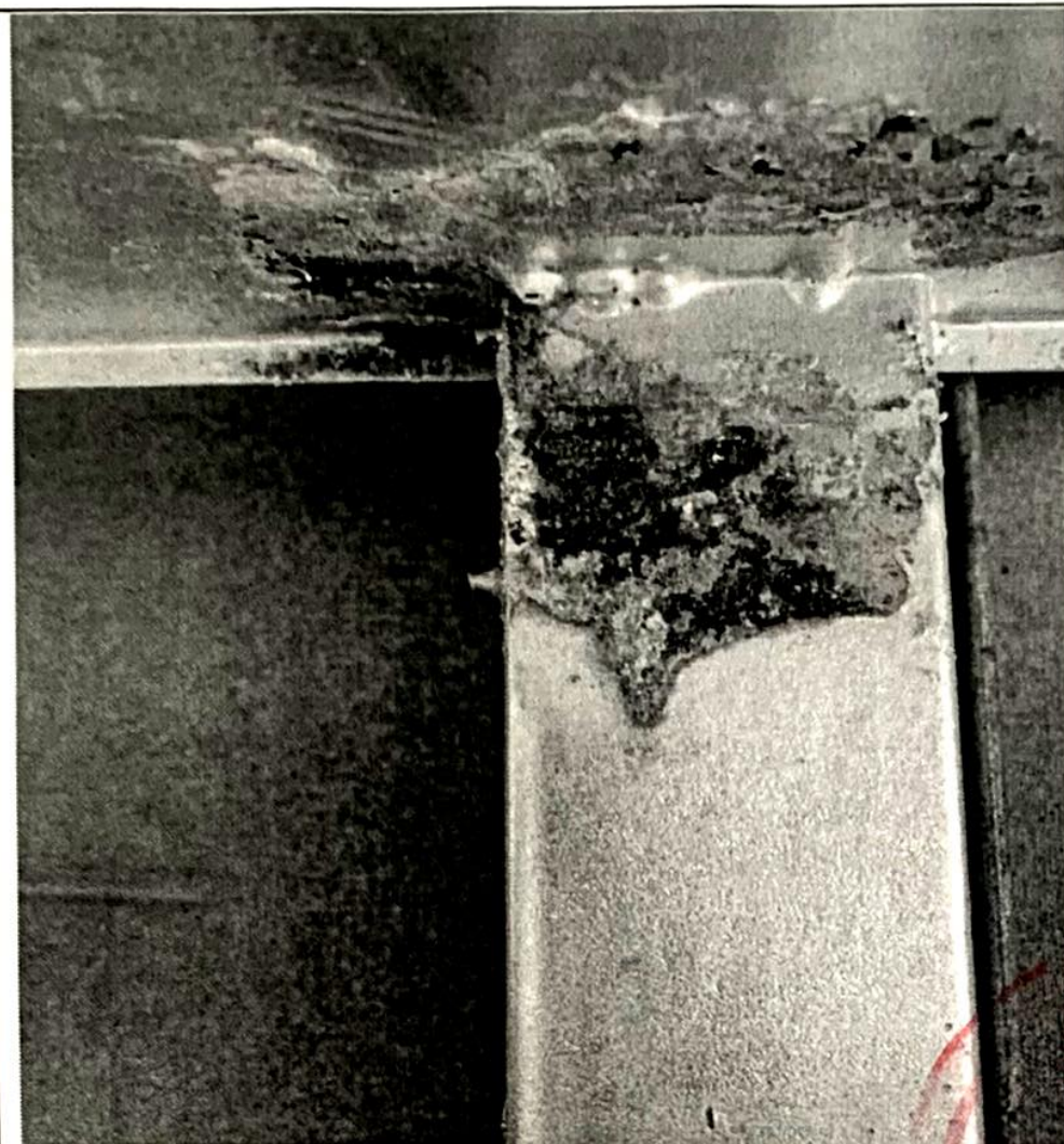
天利厂区桥架存在严重锈蚀
