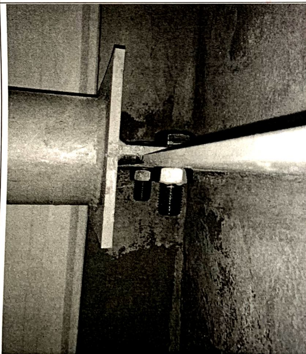
紧固件螺栓缺少垫片
