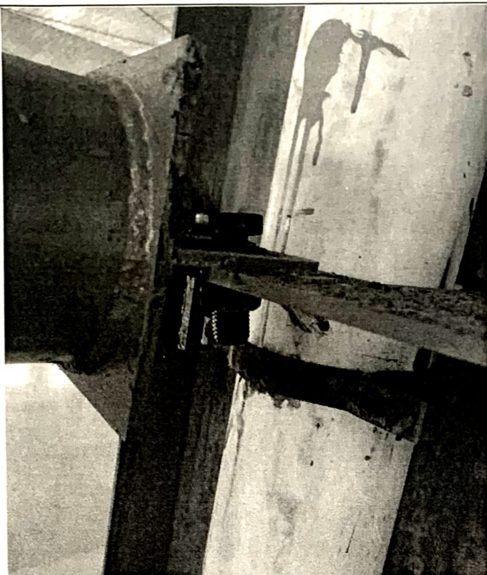
系杆紧固件螺栓未垂直安装
