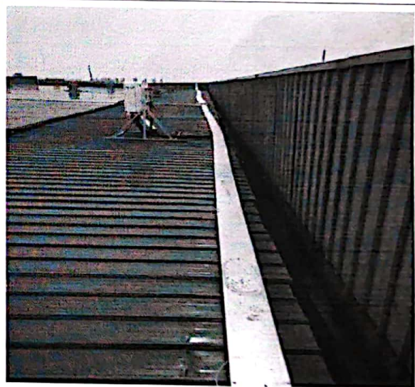
个别屋面桥架安装不顺直
