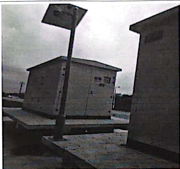
设备基础平台处监控设备未有接地线
