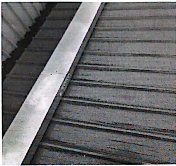
个别桥架连接处缺少跨接线
