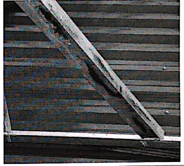
个别逆变器支架有锈迹、防腐不到位
