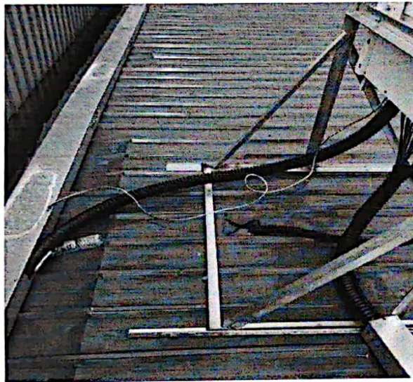
部分逆变器的接地线未绑扎固定
