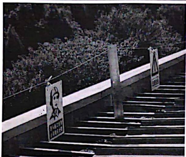
临边区域已拉设安全警戒线
