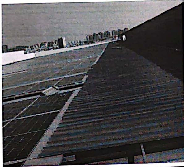
组件上的逆变器已搬离
