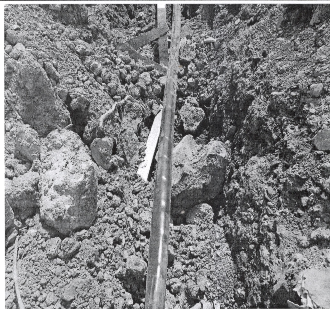
电缆沟内石块未清理
