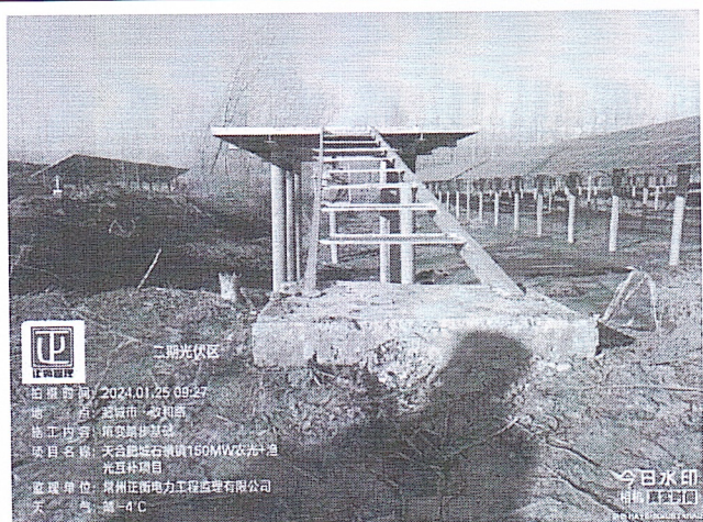
二期新胜 30 号箱变爬梯基础起粉
