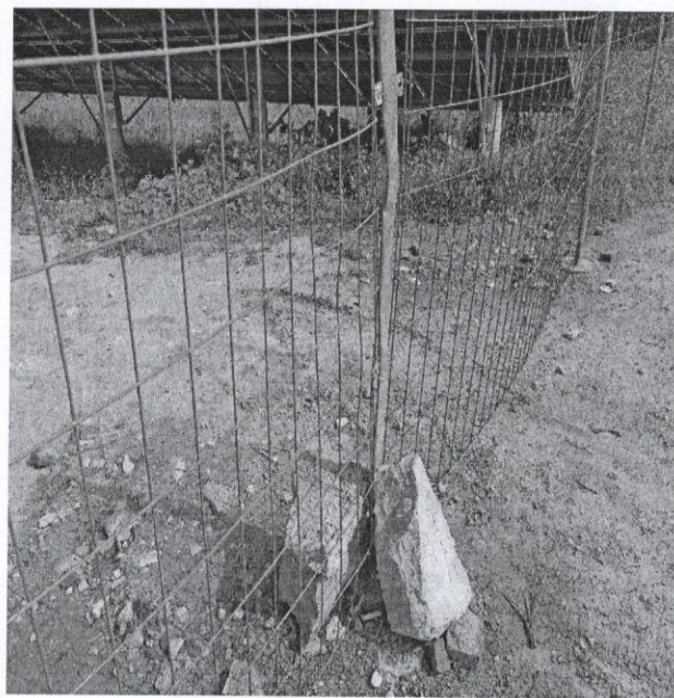
围栏立杆变形、断裂
