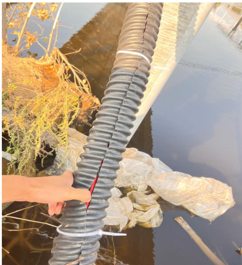
波纹管材被破坏未能起到保护作用
