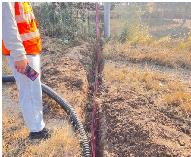
4 平方电缆过路敷设未套管
