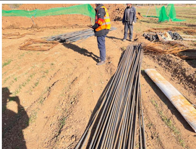
现场材未做有效保护措施
