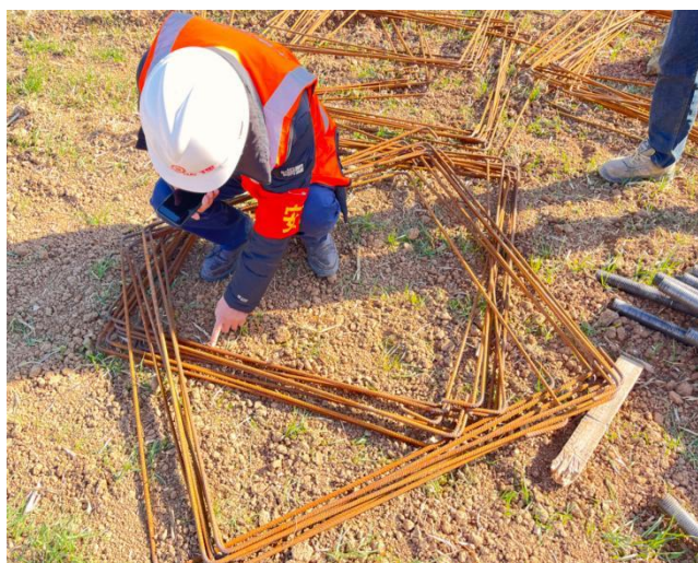
外箍筋锈绣严重
