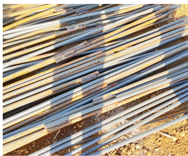
焊接处焊渣未清理
