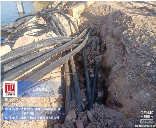
直流电缆敷设深度不足
