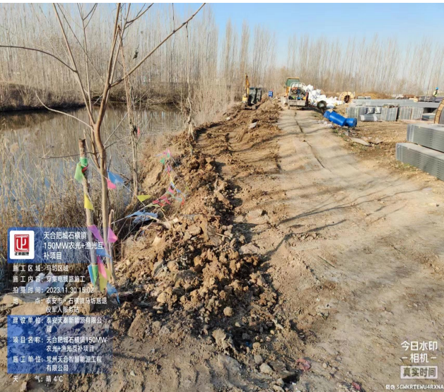
高压电缆敷设未报验进行回填
