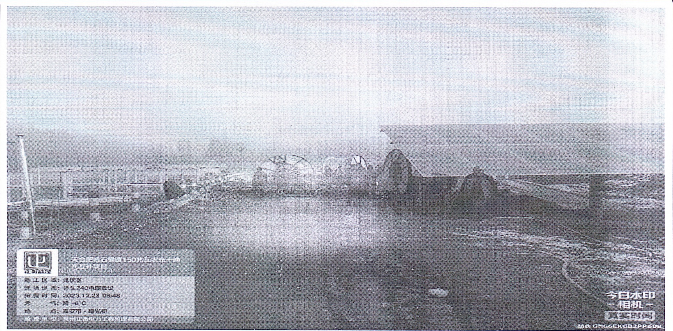
桥头 2 名箱变爬梯施工人员作业时未戴安全帽戴粉尘帽
