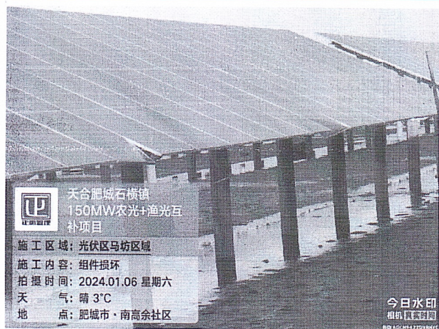
二期马坊组件受损
