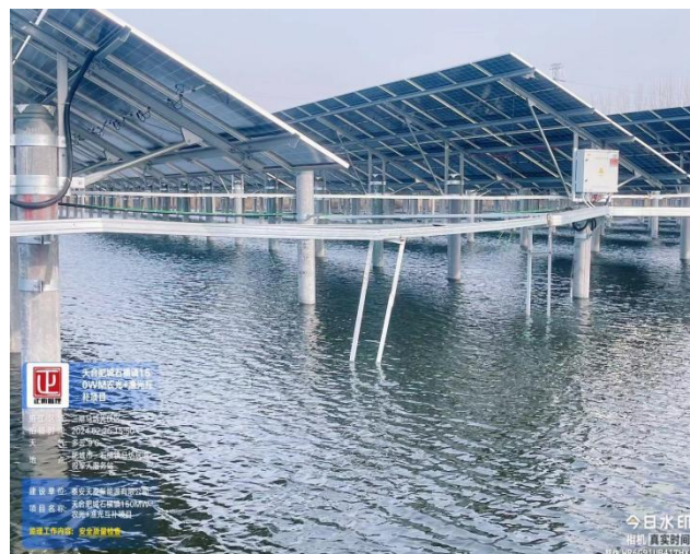
桥架不顺直、基础支架倾斜
