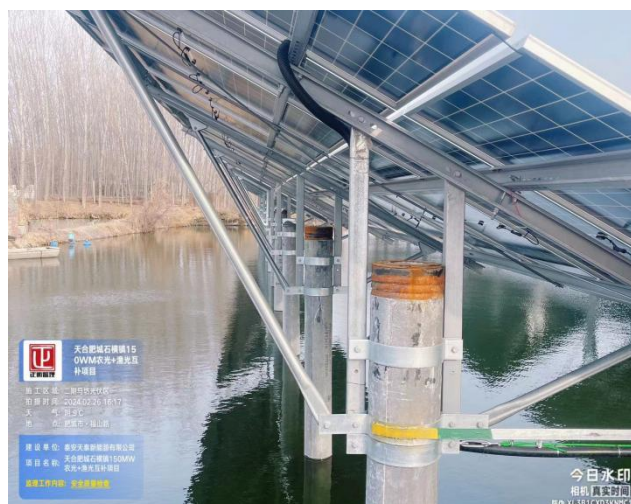
桩头未做防腐、桩顶未采用丁基防水胶带进行封堵
