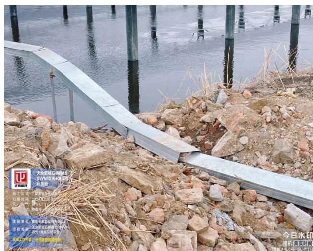
桥架盖板缝隙较大
