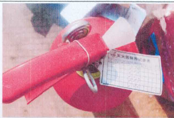
灭火器未定期检查
