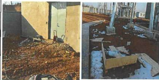
升压站现场垃圾未清理
