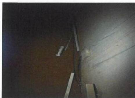
15、SF6 气体检测探头挂墙线缆未恢复
