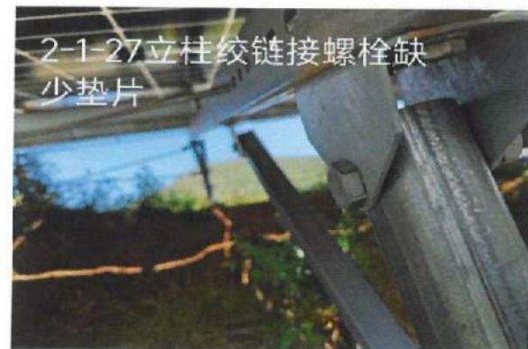
16、立柱绞链接螺栓缺少垫片
