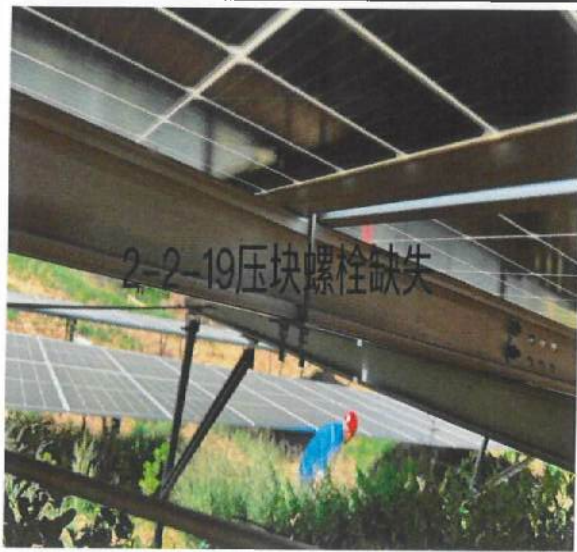
35、压块螺栓缺失
