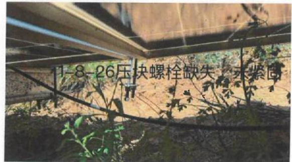
38、压块螺栓缺失未紧固
