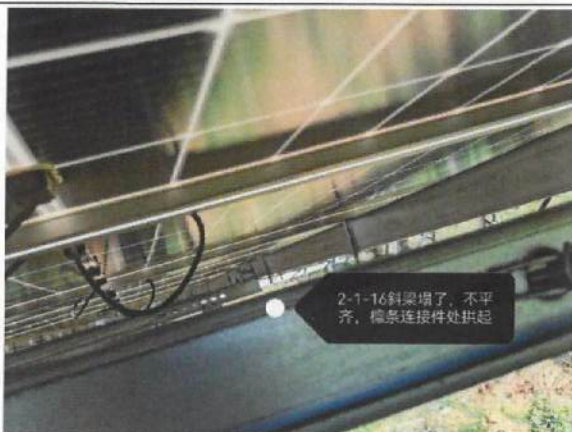
68、斜梁塌了，不平齐，檩条连接件处拱起
