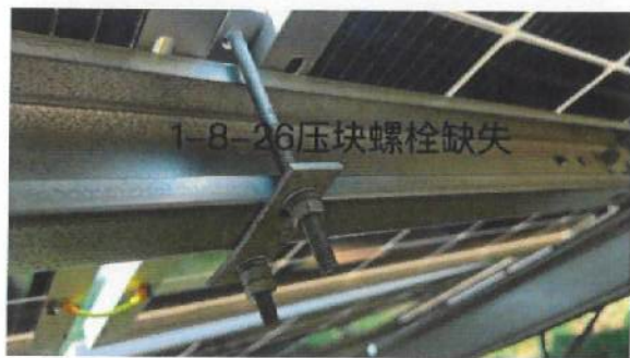
39、压块螺栓缺失
