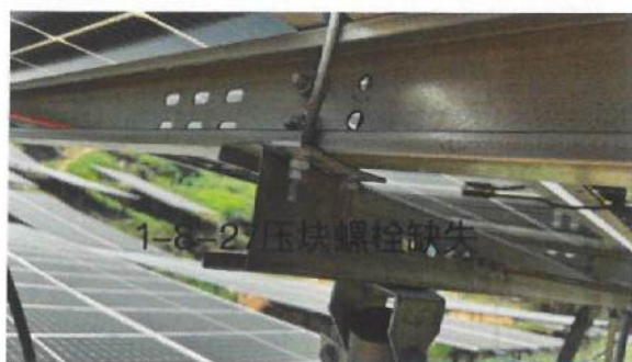
41、压块螺栓缺失
