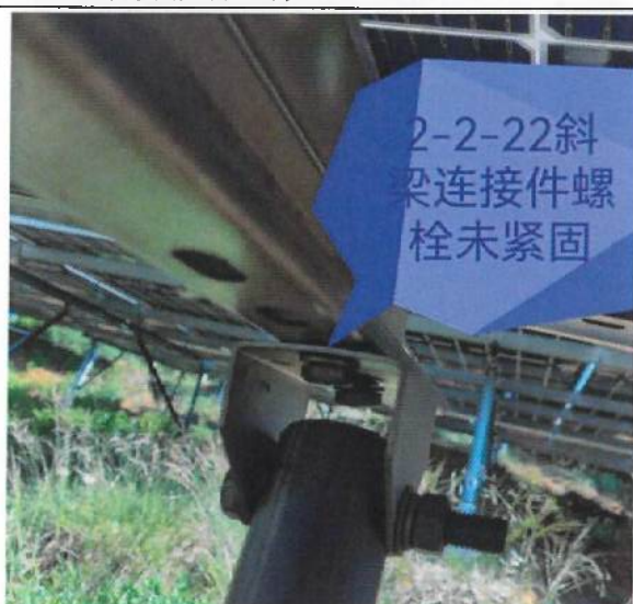
117、斜梁连接件螺栓未紧固
