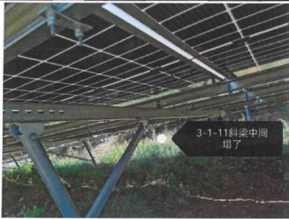
59、斜梁中间塌了
