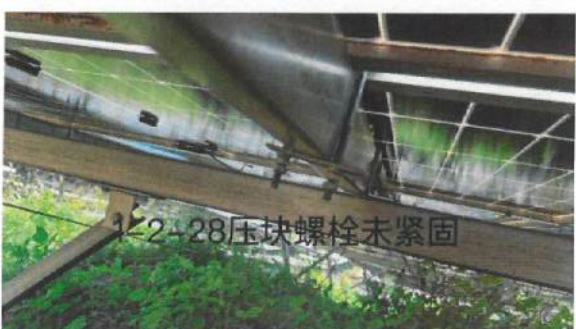
43、压块螺栓未紧固
