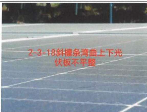
140、斜檩条弯曲上下光伏板不平整
