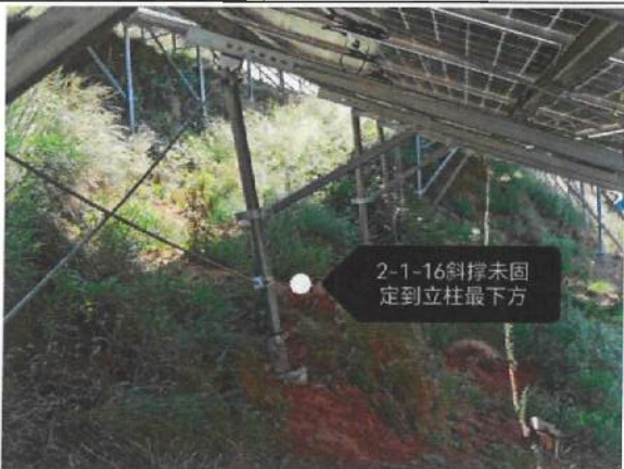
67、斜撑未固定到立柱最下方
