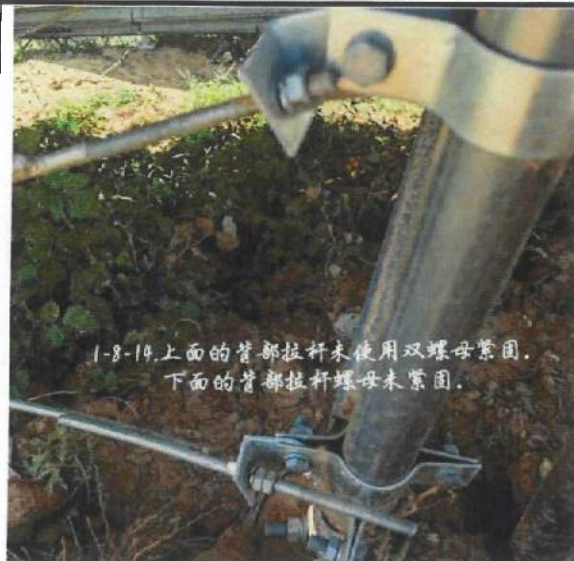
24、上面的背部拉杆未使用双螺母紧固，下面的背部拉杆螺母未紧固
