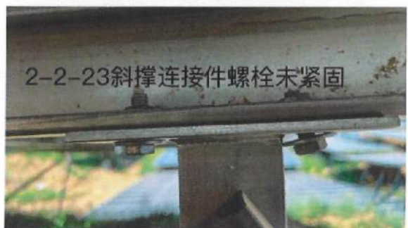
34、斜撑连接件螺栓未紧固
