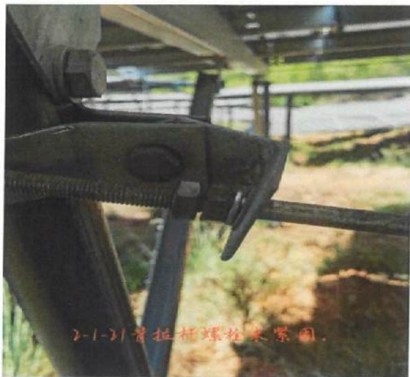
11、背拉杆螺栓未紧固
