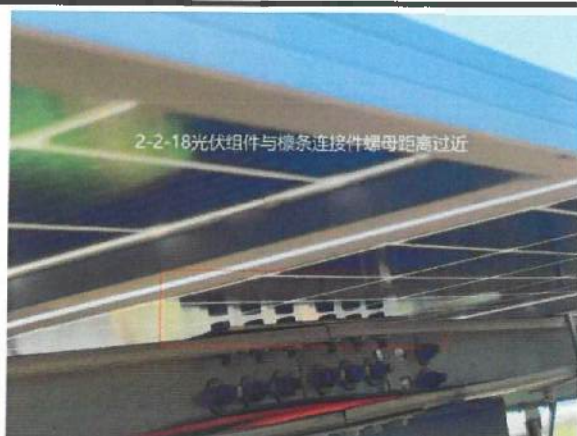
190、光伏组件与檩条连接件螺母距离过近
