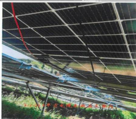
16、4平方电缆未放在支架内
