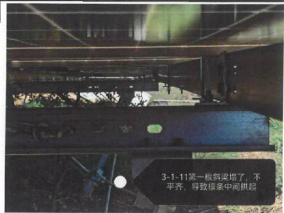
60、第一根斜梁塌了，不平齐，导致檩条中间拱起
