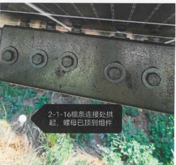
69、檩条连接处拱起，螺母已顶到组件
