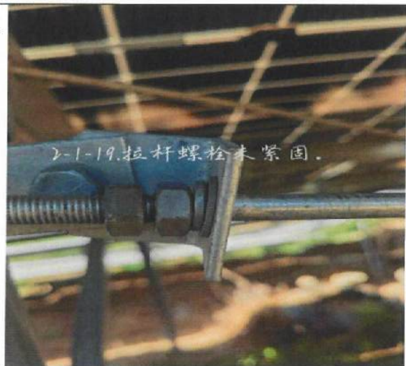
1、拉杆螺栓未紧固
