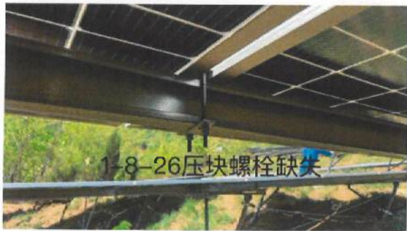
37、压块螺栓缺失
