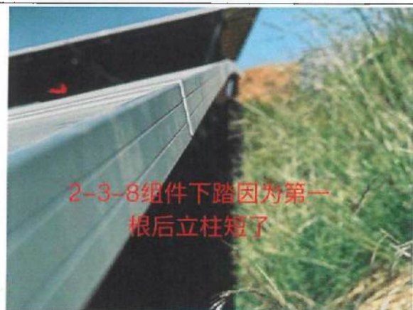
204、组件下塌因为第一根后立柱短了
