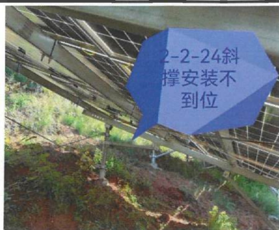
126、斜撑安装不到位
