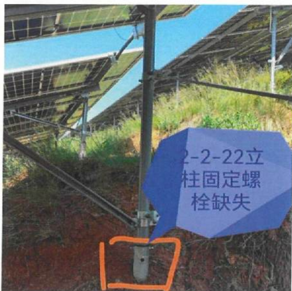
119、立柱固定螺栓缺失
