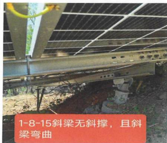
90、斜梁无斜撑，且斜梁弯曲
