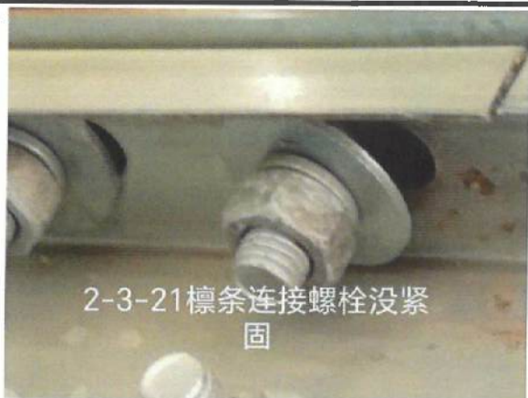
143、標条连接螺栓没紧固
