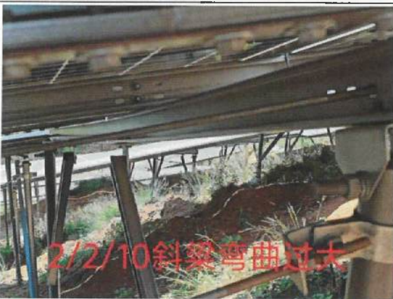
165、斜梁弯曲过大
