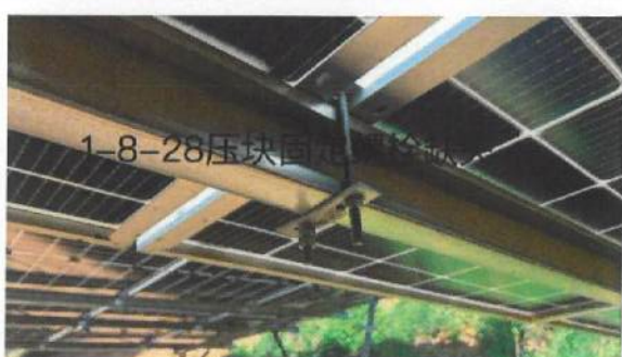
44、压块固定螺栓缺失
