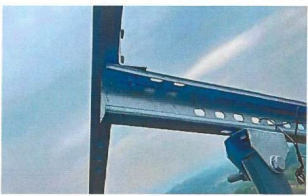
4、 斜梁与檩条安装错位
