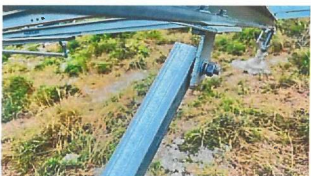
7、斜撑螺栓未紧固
