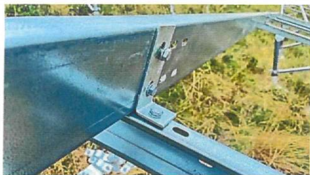
5、檩条螺栓未紧固
