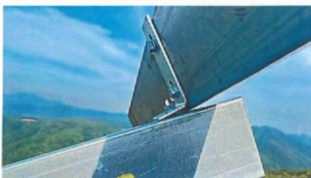
8、檩托螺栓未紧固
