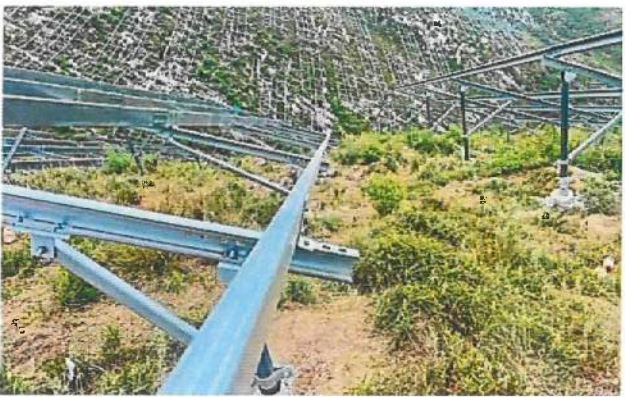
3、 斜梁安装不在同一直线
