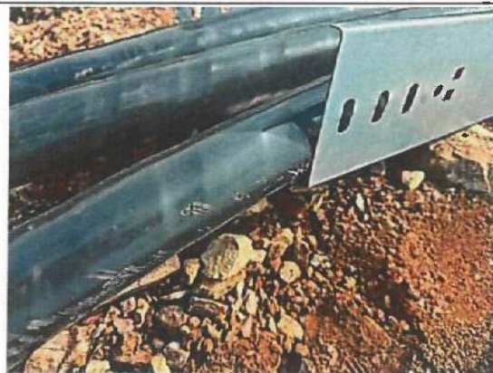
图 2：电缆绝缘层破损严重
