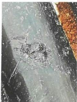
图 1：电缆绝缘层破损严重
