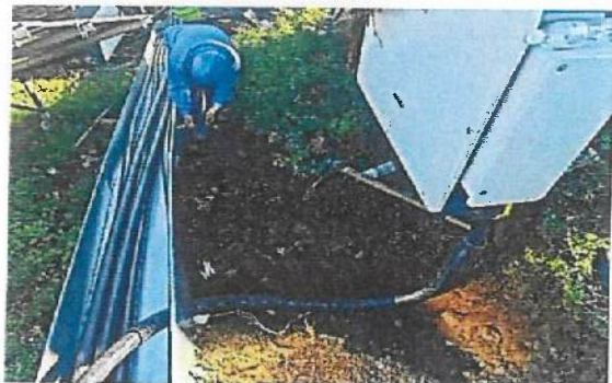
逆变器侧电缆预留长度不足
