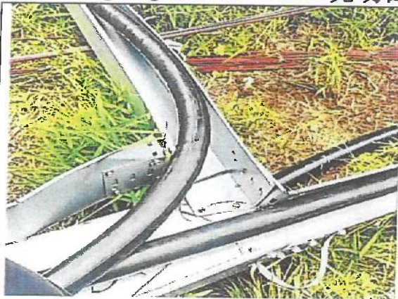
桥架安装、电缆敷设不符合要求
