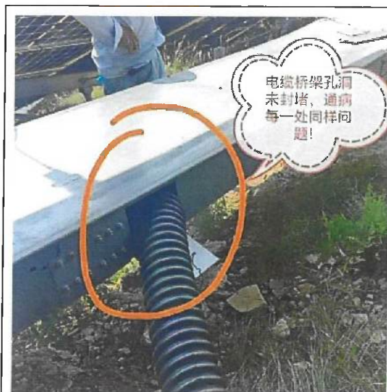
电缆桥架孔洞未进行防火封堵
